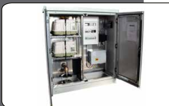
Schakelkast met systeembesturing en belichtingspompen.
